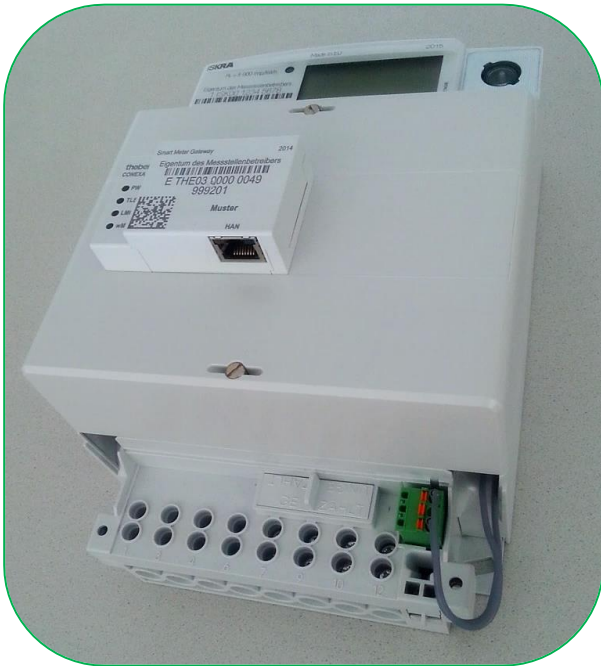
Bild 48: Zähler mit montierten SMGw und Moduldeckel. Richtige Position und Länge von Power Kabel
